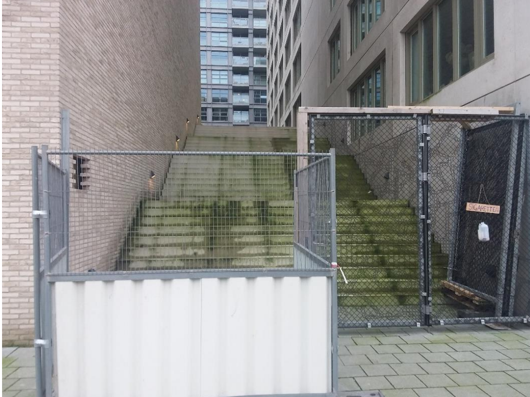
Afbeelding uit 2019: Zo willen we het niet. Pas opgeleverd en dan al problemen met verhoogde nieuwe semi openbare ruimte op NDSM-terrein Kraanspoor in Amsterdam-Noord.
