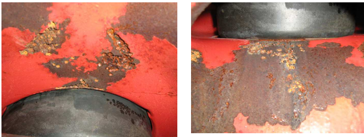
Figuur 11: Cavitatieschade PSV.
